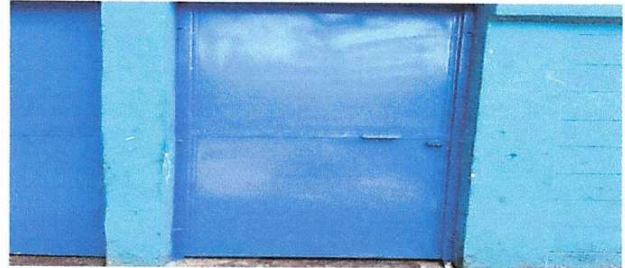
Foto 2: Mantenimiento a estructura (lijado, cambio de tubo , cepillado, sujeciones, aplicación de pintura)
