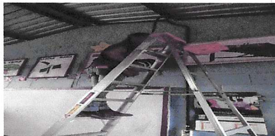
Foto 9: Sustrucción de plafoneras
