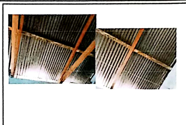
Foto 2: Este es el estado en que se encuentra la madera del techo del establecimiento.
