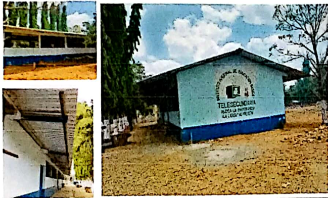
Renglon No. 1. Estas fotos son del proyecto del cambio del techo de la estructura de madera por metal y la lamina por troquelada, finalizado.
