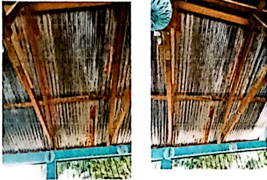
Foto1: Esta es del estado en que se encuentra lámina del establecimiento.
