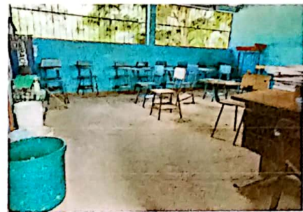
Foto 6: Esta aula solo tiene piso rustico, por lo que al hacer la limpieza se genera demasiado polvo.
