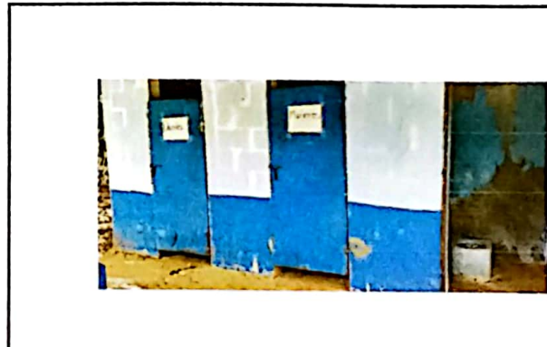
Foto 4: Estas son las puertas de los baños.
