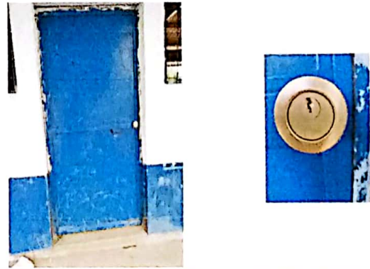
Renglon No. 4: Foto del proyecto de cambio de las chapas de las puertas de las aulas ya finalizado .
