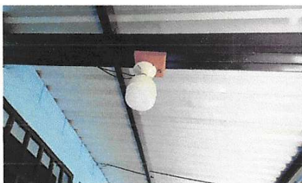
Foto 11: Sustitución de lámparas tipo Led
