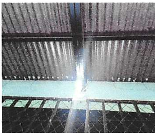
Foto 11: Sustrucción de lámparas tipo Led
