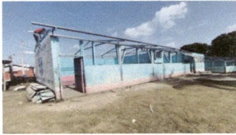
Foto 1: Sustrucción de lámina, por lamina troquelada aluzinc calibre 26 modulo de aulas y direccion
