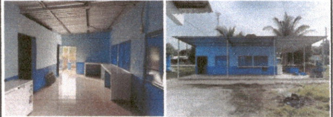
Foto 8: Se esta realizando el repello y cernido en las paredes en la parte interna y externa de la cocina.
