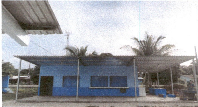
Foto1: Se realizo levantado de pared, cambio de lamina, instalacion de puertas y ventanas, intalacion de energia electrica, pintura en la parte externa de la cocina y construccion de piso de concreto.
