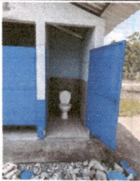
Foto 3: Se esta sustituyendo las Tazas lavables, se esta colocando ceramica en los baños.
