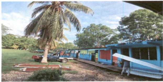
Sustitución de lámina, por lámina troquelada aluzinc calibre 26, sustitución de capote de lámina para lámina troquelada, sustitución de elementos de fijación.
