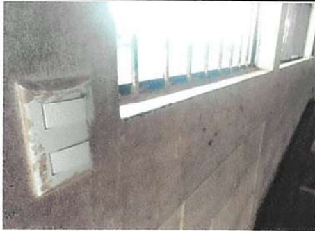
Foto 7. APAGADORES EN MAL ESTADO
