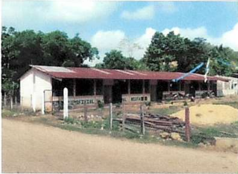
Foto1: LAMINAS EN MAL ESTADO DE LAS 4 AULAS, NECESITAN CAMBIOS
