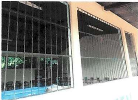
Foto 9. LOS BALCONES NECESITAN LIMPIEZA YA ESTAN OXIDADOS
