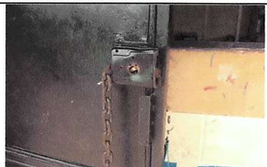
Foto 12. CHAPAS EN MAL ESTADO
