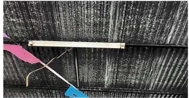
Foto 4: EL CABLE DE LA LUZ QUE ESTA ENTRO EL AULA NO FUNCIONA
