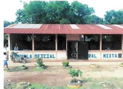
Foto 2: PAREDES INTERNAS Y EXTERNAS NECESITAN NUEVAS PINTURAS.
