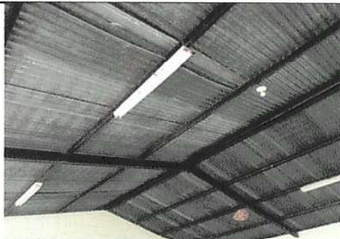
Foto 11. NECESITA NUEVA PINTURA TODAS LAS ESTRUCTURAS METALICAS (TUBOS Y COSTANERAS).
