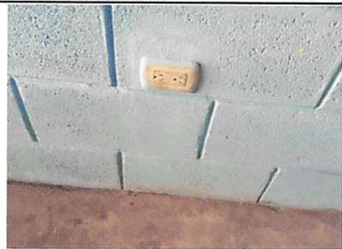
Foto 8. TOMACORRIENTE EN MAL ESTADO
