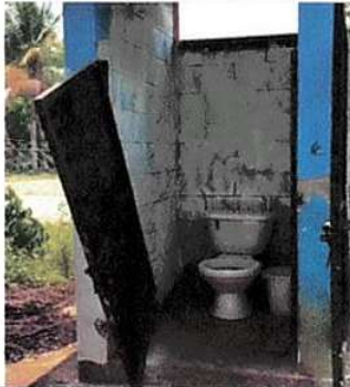
Foto 3: LA PUERTA DEL BAÑO QUIERE REPARACION
