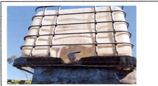
Foto 3: El sistema de agua con rajaduras provocados por el sol
