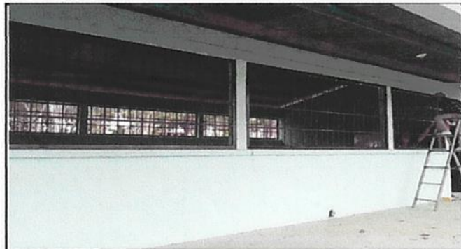
Foto 3: Sustrucción de 4 balcones de metal, lado frontal.
