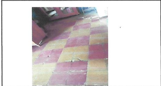
Foto 3: Piso direccion en mal estado
