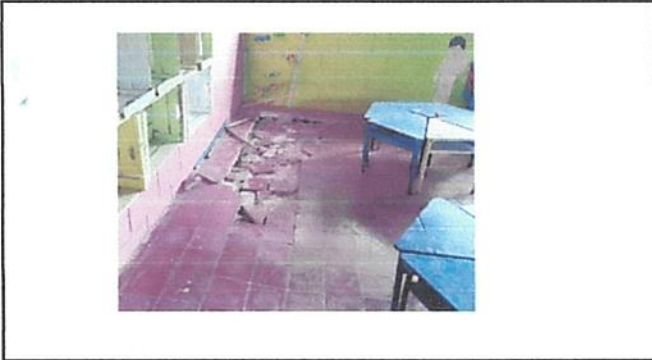
Foto 2: Aula piso en mal estado
