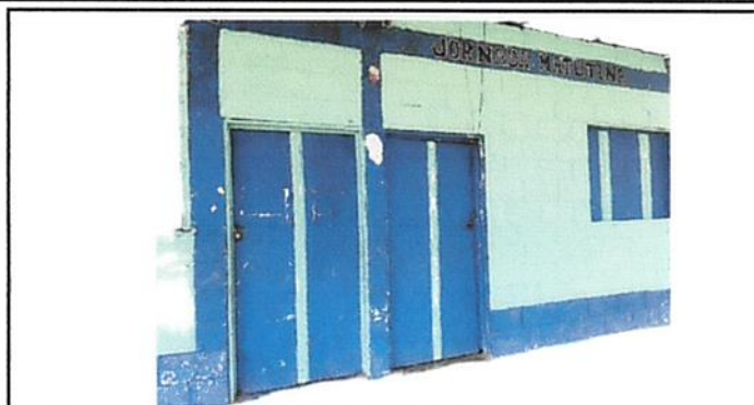
Foto 2: Fotografía de puerta de madera 2 y 3 que se necesitan ser sustituida.
