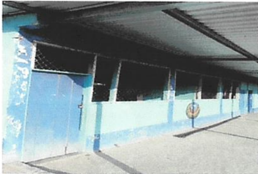
Foto 3; Reparación de soleras intermedias y columnas ya que se encuentra en mal estado.
