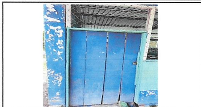
Foto1: Fotografía de puerta de madera 1 que se encuentra en mal estado y necesita ser sustituida.
