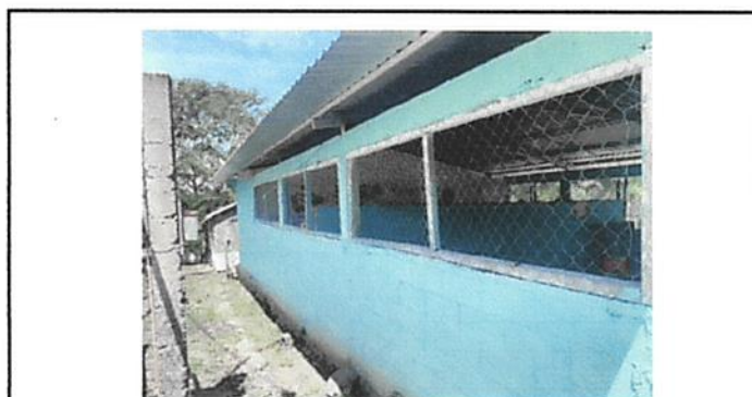
Foto 4: Fotografía donde se evidencia ya el mal estado de los balcones y malla de las ventanas de las aulas, parte trasera de la escuela.
