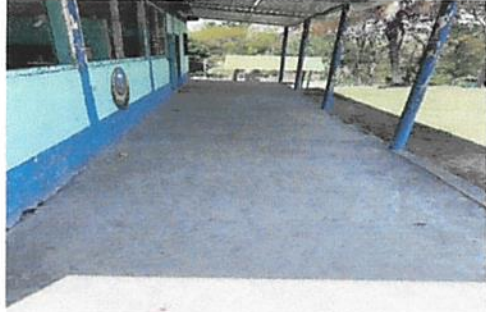
Foto 1: Fotografía del piso rustico, que se necesita ser sustituido.
