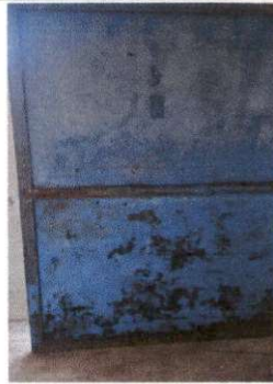
Foto 2: Sustrucción de puerta
