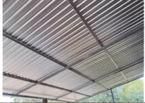
Foto 2: Finalización de la sustitución de costanera, lámina, tubos cuadrados y capote, todo fue instalado con material legítimo.
