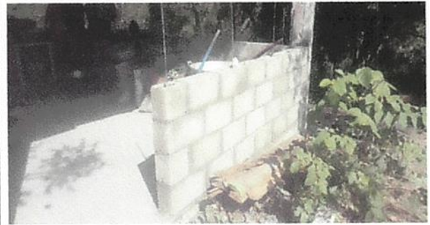
Foto 4: Mantenimiento a estufa rural. Unidad M2
