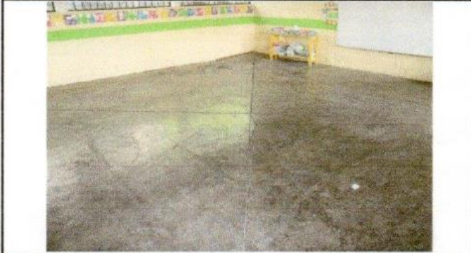
Foto 2: Se muestra un ángulo del piso que necesita reemplazarse.
