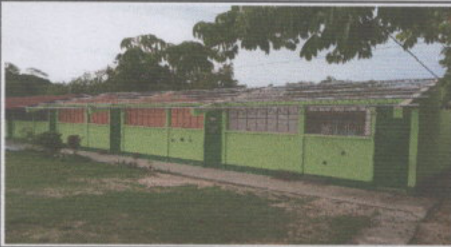
Foto 1: En esta fotografía se puede observar la instalación de la estructura de soporte en las respectivas aulas.
