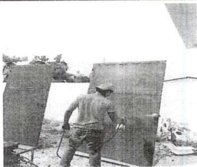
Foto 3: Puertas de Metal (Mantenimiento a estructura (lijado, cambio de tubo, cepillado, sujeciones, aplicación de pintura)
