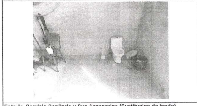
Foto 6: Servicio Sanitario y Sus Accesorios (Sustrition de Inodo)
