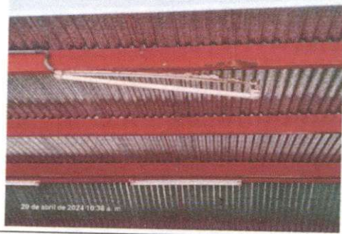
Foto 4: Sistema Electrico en mal Estado ✓
