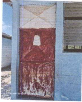
Foto 1: Puerta oxidada y en malas condiciones. ✓
