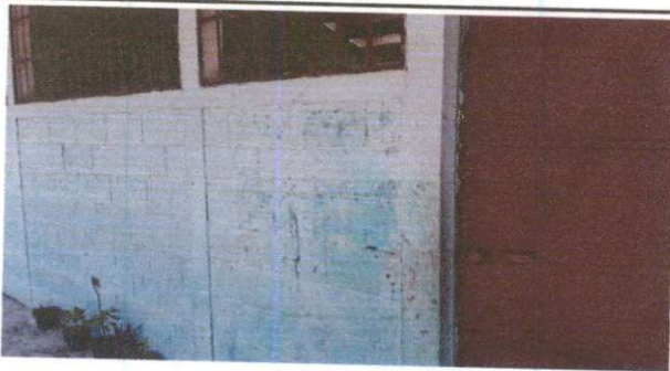
Foto 5: Pintura de Paredes deteriorada. ✓
