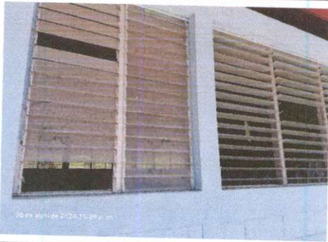
Foto 3: Percianas sin vidrios. ✓
