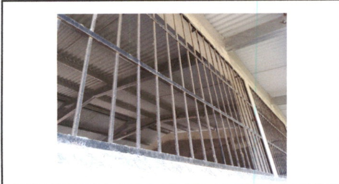
Foto 1: Mantenimiento balcones de metal antes
