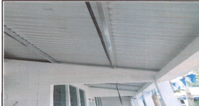
Foto 4: SUSTITUCIÓN DE ESTRUCTURA DE TECHO DE MADERA POR METAL Y METAL POR METAL
