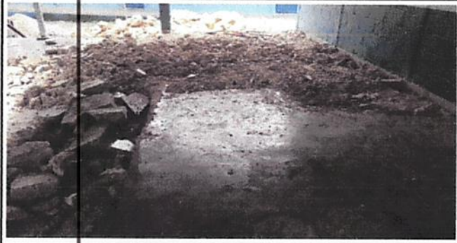
Foto 1: Sustrucción de torta de concreto
