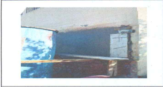
Cernido en muro y cisterna
