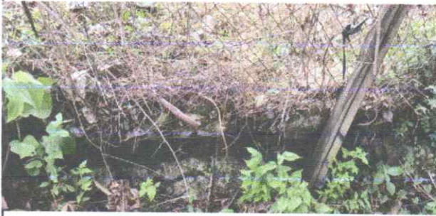
En esta foto se describe la muralla de maya y se puede observar los cimientos que la corriente de agua la les lavo el pie.
