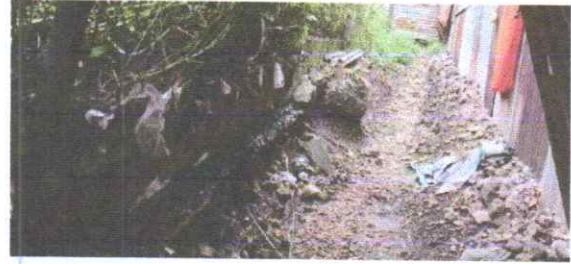
Se describe los cimientos de la maya, donde tiene tres hiladas de block de la Escuela Cesario Cetina, mismas que la corriente de agua ya les lavo el pie.
