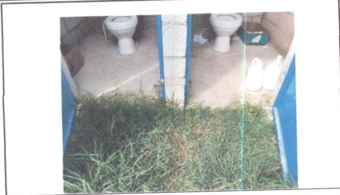
Foto 7: No existe banqueta frente a baños
