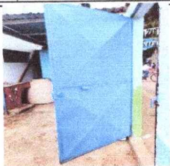
Foto 1: Mal estado de chapa en puerta entrada principal que se encuentra por desprenderse.
