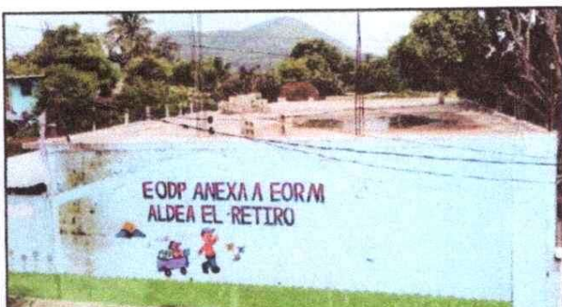
Foto 3: Se necesita impermeabilización en la losa, ya que se filtra el agua en la terraza de las aulas afecta en la salud y proceso enseñanza aprendizaje de los alumnos(as).
