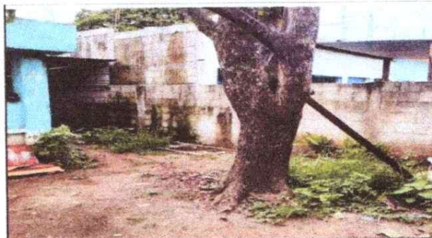
Foto 4: Debido a las constantes lluvias se filtra el agua en el muro de cocina, por ello se generó moho, lo cual perjudica a la salud de estudiantes.
