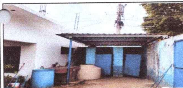
Foto 5: El área de baños necesita limpieza en fosa séptica debido a que ya se encuentra por colapsar y así causar un desbordamiento y contaminación en puerta de un baño e instalación de depósito de agua porque con el que se cuenta no se da abasto para cubrir
