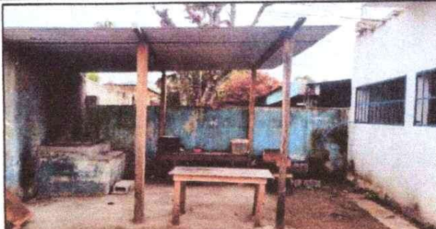
Foto 2: Se puede observar la cocina y galera se encuentra en mal estado debido a las inclemencias del tiempo.
