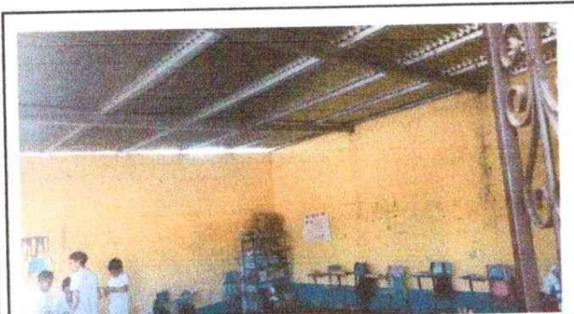
Foto 3: MEJORAMIENTO DE INSTALACIONES ELECTRICAS
