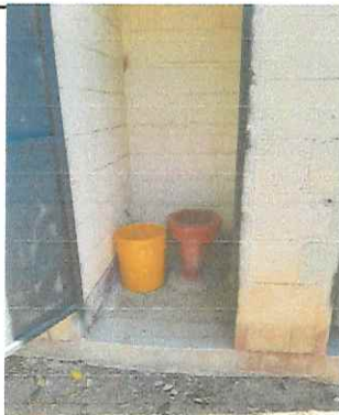
FOTO 3: SERVICIOS SANITARIOS A CAMBIAR POR PORCELANA
