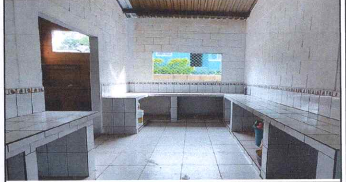
FOTO: 4 SUSTITUCION DE 3 VENTANAS POR VENTANAS CORREDIZAS DE PVC BLANCO CON VIDIRO DE 5 MM TRANSPARENTE
