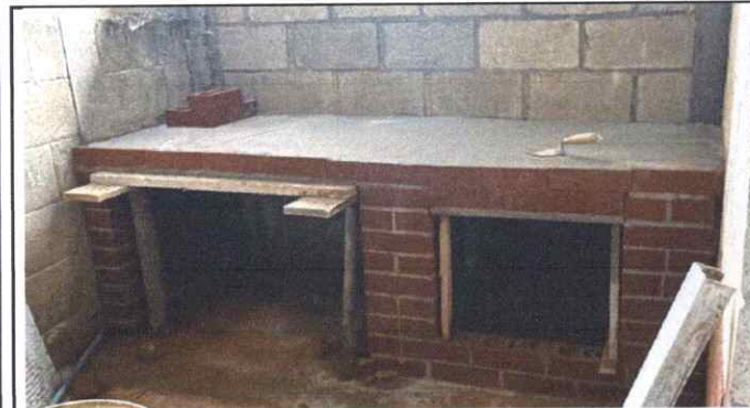
Foto 3: meioramiento de cocina en condiciones inadecuadas para preparación de alimentos
