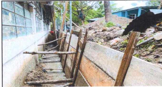
Foto 1: meioramiento de muro perimetral trasero, colapsado por humedad y lluvia en 2023
