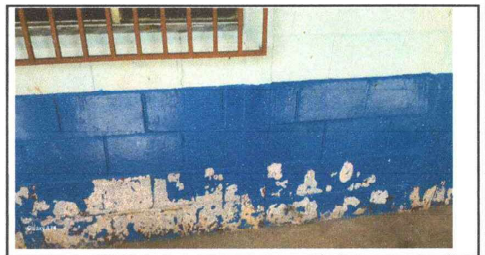
Foto 6: La presente fotografía indica el deterioro de la pintura.
