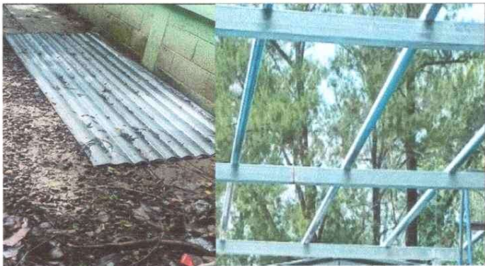
Foto 3: SUSTITUCION DE LAMINA TROQUELADA ALUZINC CALIBRE 26, SUSTITUCION DE ESTRUCTURA DE SOPORTE DE METAL DE TECHO EN COCINA
