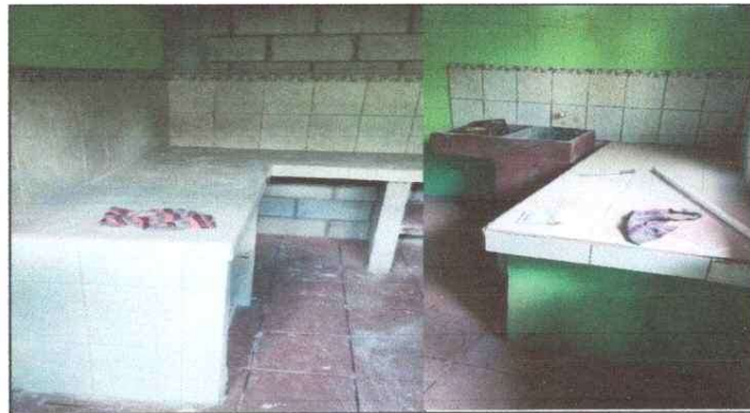
Foto 4: REPARACION DE AZULEJO EN ESTUFA RURAL, INSTALACION DE AZULEJO EN MUEBLE DE COCINA, INSTALACION DE PISO CERAMICO ANTIDESLIZANTE
