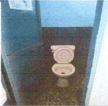
Foto 1: Sustrucción de sanitarios por mal estado
