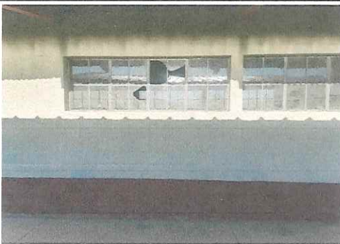
VIDROS DE VENTANERIA A REPARAR
