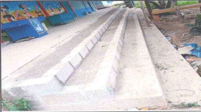
Foto 1: CONTENCIÓN A MODULO DE GRADAS POR DAÑO EN BANQUETA DE SALONES DE CLASE
