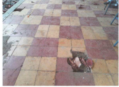
Foto 2: Estado actual del piso
