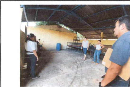
Foto 7: Estado Actual del piso
