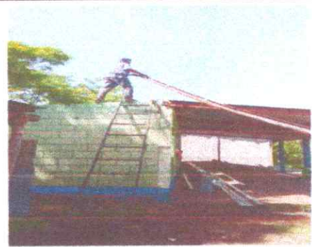
Foto 2: sustitucion de estructura metalica en aula en mal estado por estructura portante galvanizada
