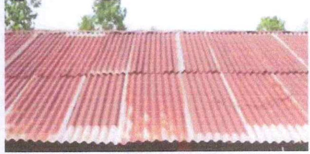
Foto 2: Lamina de Cocina en mal estado para sustitución
