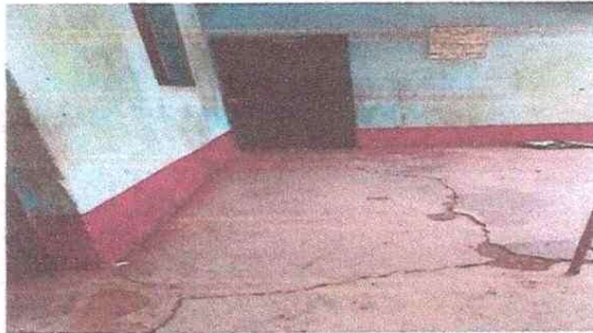
Foto 3: Módulo Aula: Paredes y piso de cemento en mal estado (Reparación de grietas, repello y sustitución de torta por piso cerámico) en area de corredor.
