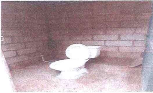
Foto 1: Módulo Sanitario: Torta de cemento a sustituir por piso cerámico y paredes a mejorar en area de sanitarios
