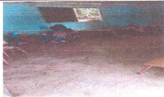
Foto 4: Módulo Aula: Piso y paredes de salón de clase en mal estado, mejoramiento con repello y piso ceramico
