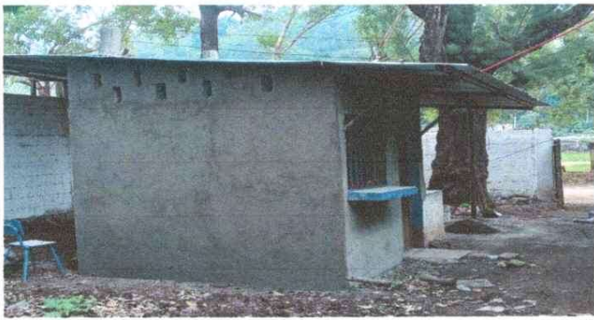
Foto1: Modulo cocina: mejoramiento de paredes con repello rustico en paredes externas finalizado.
