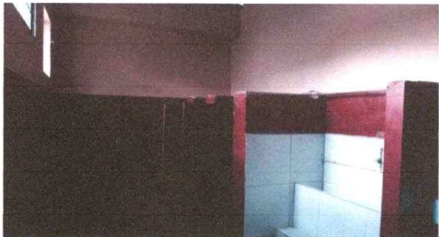
Foto1: MODULO BAÑOS: Baños totalmente renovados con puertas nuevas, pintura nueva y mingitorio totalmente remodelado.
