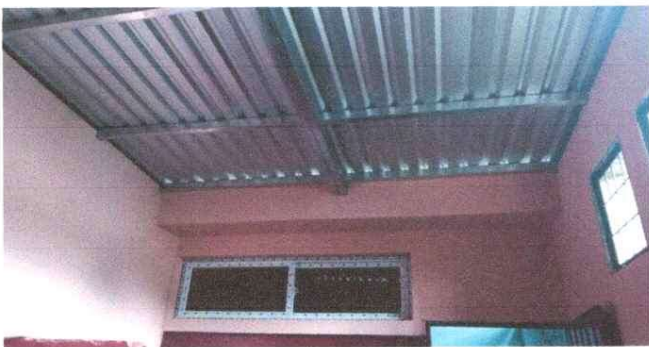
Foto 3: Modulo baños: mantenimiento de paredes con pintura nueva y sustitucion de ventanales, concluido.
