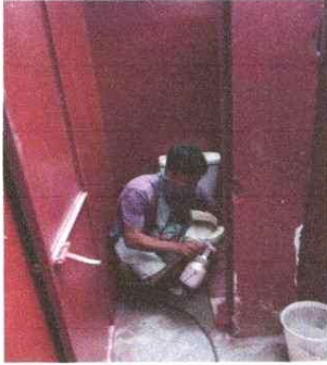
Foto7: Modulo baños Paredes sin repello en mal estado, deteriorandose por mucha humedad.
