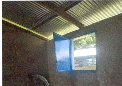
Foto 8: Detalles finales de mantenimiento de ventanas metálica de Aula (lijado, pintura y soldadura)
