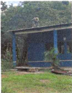
Foto 9: Proceso de sustitución de lámina en mal estado por lamina troquelada calibre 26 en aulas.
