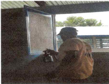
Foto 15: Proceso de mejoramiento de ventanas de aula con pintura, lijado y soldadura.
