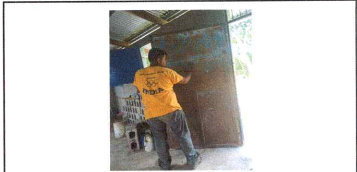
Foto 14: Ejecución de trabajos iniciales de mantenimiento de puertas metálicas(lijado, pintura y soldadura) en aulas.
