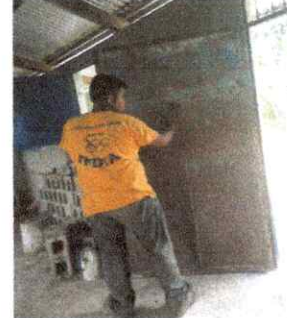
Foto 14: Ejecución de trabajos iniciales de mantenimiento de puertas metálicas(lijado, pintura y soldadura) en aulas.
