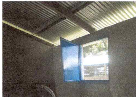
Foto 8: Detalles finales de mantenimiento de ventanas metálica de Aula (lijado, pintura y soldadura)
