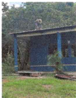
Foto 9: Proceso de sustitución de lámina en mal estado por lamina troquelada calibre 26 en aulas.
