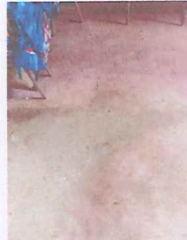
Foto2: Torta de cemento dañada a sustituir por rion puso de granito
