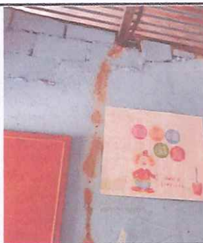
Foto5: Paredes dañadas a mejorar con repello y cernido
