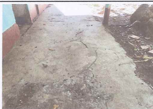
Foto 6: Entorotado de corredor en mal estado.
