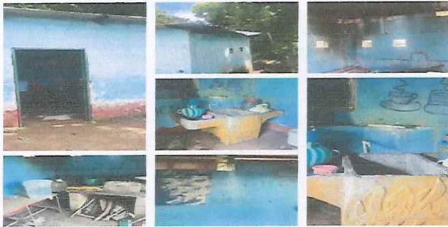
Foto1: Cocina sin piso y sin repello, se cubrirá con terraza para mayor seguridad y se instalará un tinaco para garantizar el servicio de agua.
