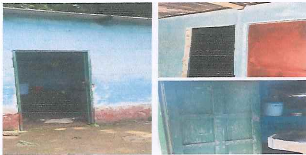
Foto 3: Puertas en mal estado.
