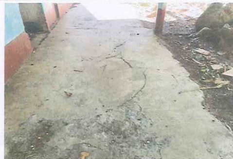
Foto 6: Entortado de corredor en mal estado.
