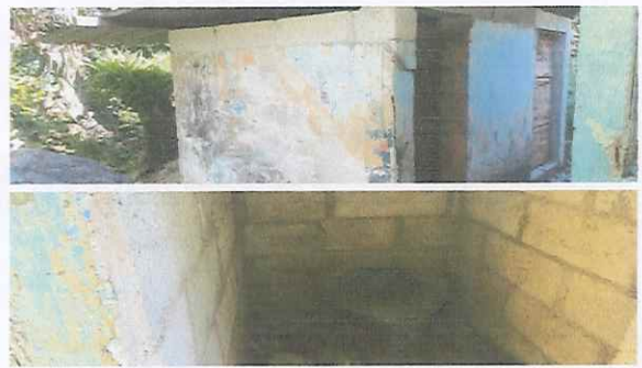
Foto 2: Área de baños sin piso, sin repello en paredes, sanitarios de letrina y lamina en mal estado
