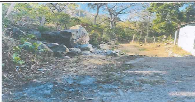
Foto 5: Entortado del patio en mal estado, se hará reparación del mismo.
