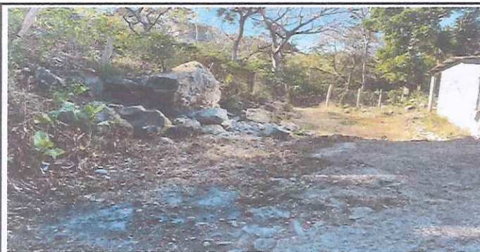
Foto 5: Entortado del patio en mal estado, se hara reparación del mismo.
