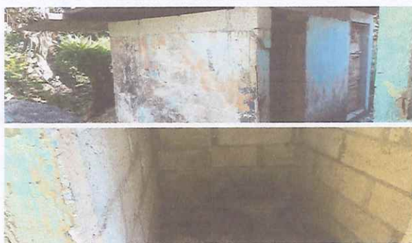
Foto 2: Area de baños sin piso, sin repello en paredes, sanitarios de letrina y lamina en mal estado
