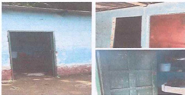
Foto 3: Puertas en mal estado.
