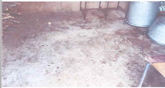
Foto7: Sustrucción de torta rustica por piso de granito en area de cocina.
