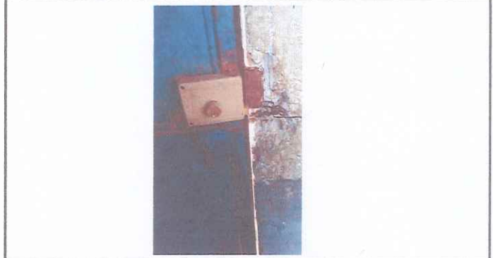
FOTO8: Sustrucción de Chapa de puerta de modulo 3.
