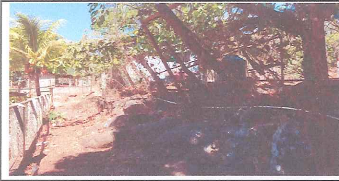
Foto 11: Sustrucción de serco en mal estado por base de cemento block y malla.
