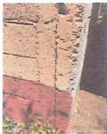
Foto 3: Paredes de aulas en malas condiciones para mejorar y ampliar.
