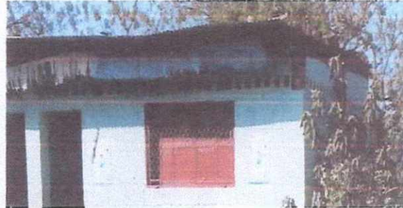
Foto 2: Lámina de aulas en mal estado (sostenidas con el peso de piedras) a mejorar con lámina troquelada calibre 26.
