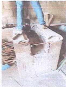
Foto 5: Área y polletón de cocina en malas condiciones a mejorar con colocación de azulejo y reparación de detalles estéticos.
