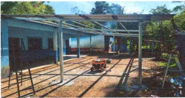
Foto 3: Finalización de trabajos de sustitución de estructura portante en mal estado por estructura galvanizada nueva en área de patio.
